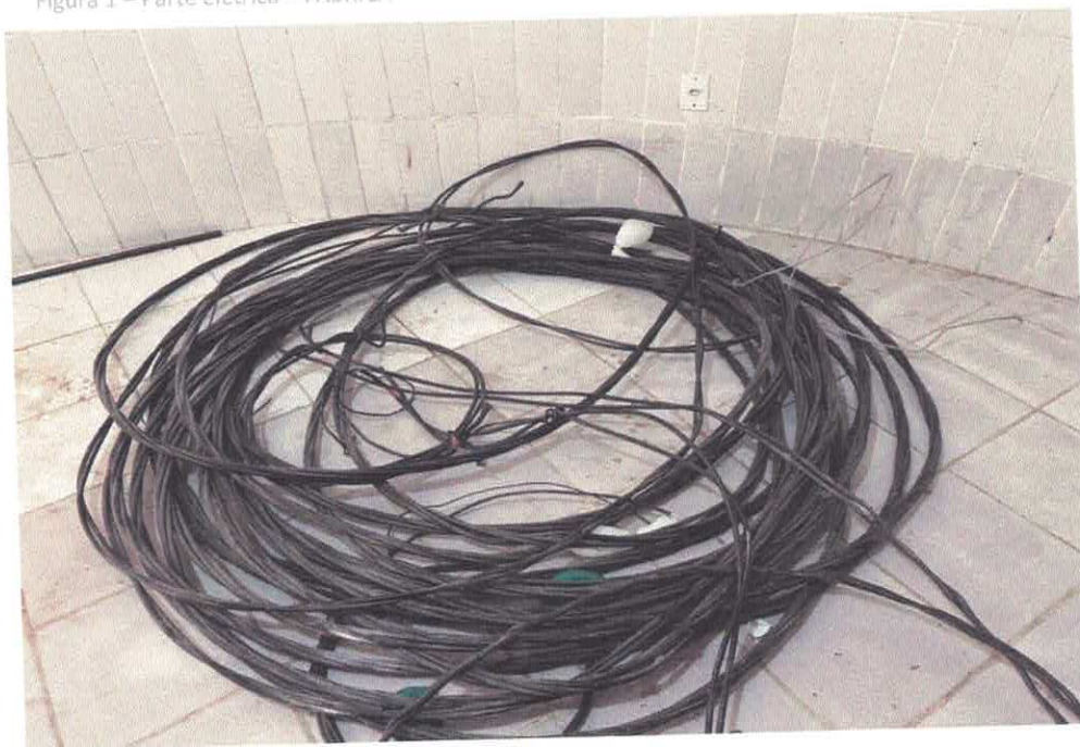
Figura 2 – Parte elétrica – FÁBRICA
