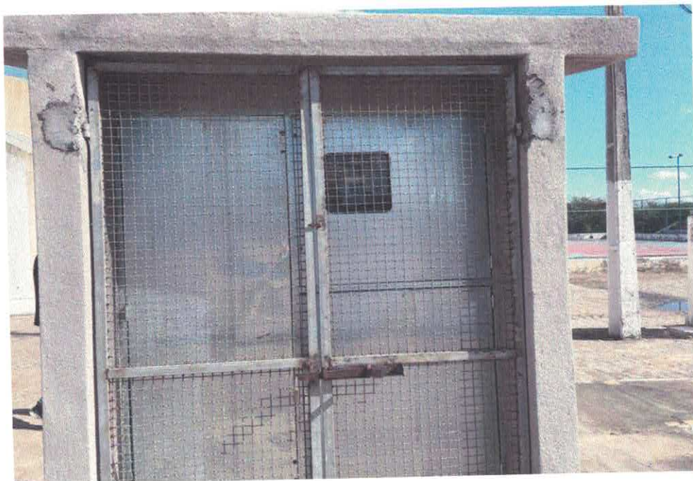
Figura 1 – Parte elétrica – FÁBRICA
