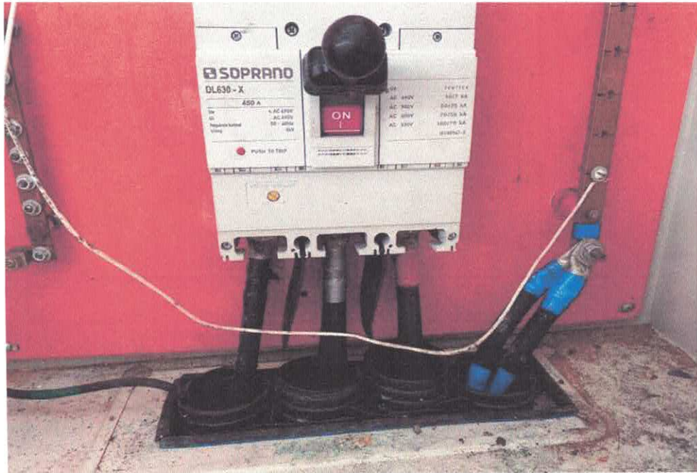
Figura 1 – Parte elétrica – FÁBRICA
